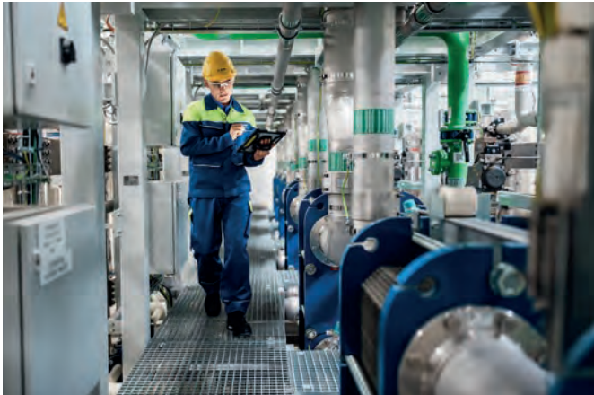
In Ludwigshafen produziert BASF seit März 2025 CO-freien Wasserstoff: Deutschlands größter PEM-Elektrolyseur läuft mit 54 Megawatt Leistung.
